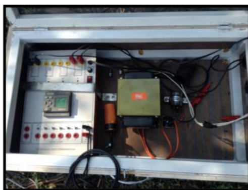
ภาพที่ 9 กล่องระบบควบคุมเครื่องให้อาหารกึ่งอัตโนมัติ
