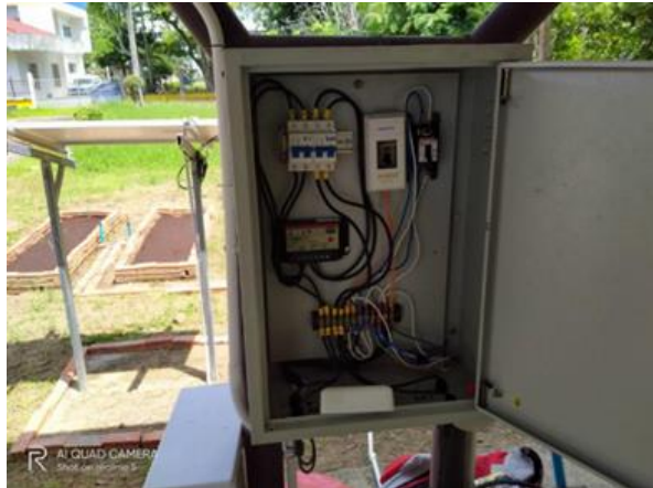
ภาพที่ 6 ชุดควบคุมโซล่าเซลล์
