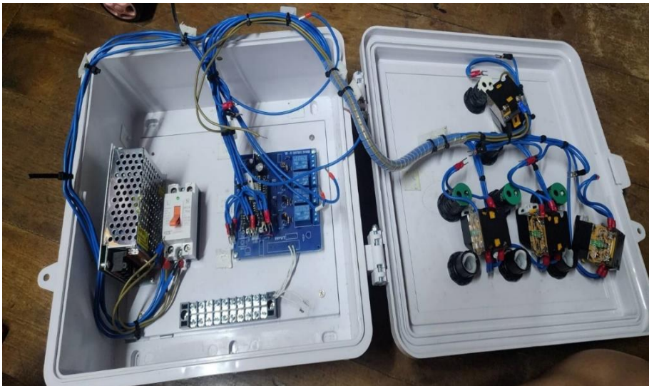
ภาพที่ 2 แสดงตู้ควบคุม(Hardware) ที่จัดทำขึ้น
